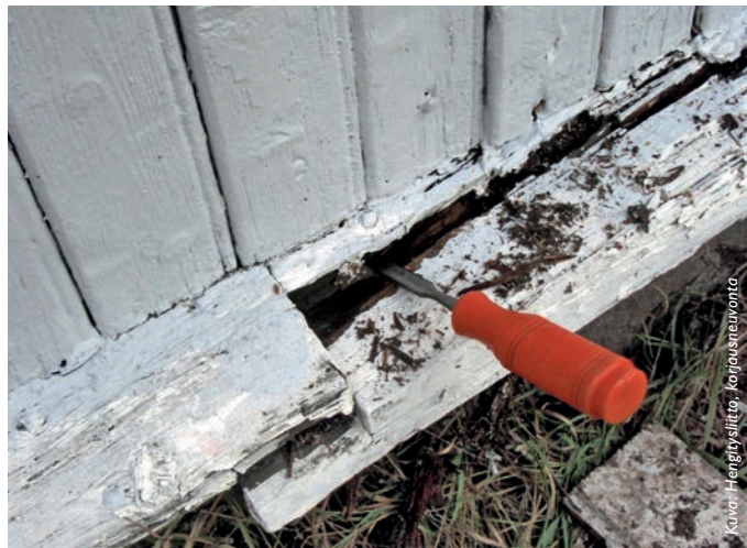
Julkisivulaudoitus ja muotolista ovat lahoja laudoituksen takaa puuttuvan tuuletusraon vuoksi.
