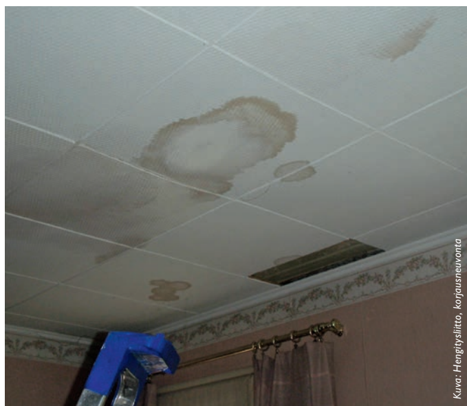
Kattovuodon aiheuttamia kosteusjälkiä välipohjassa.
