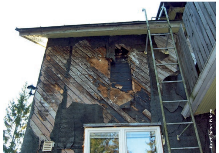
Tiivis huopa väärässä paikassa rakenteen ulkopinnalla voi aiheuttaa vakavia vaurioita.
