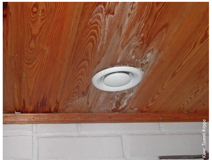
Huonosti eristettyyn ilmanvaihdon poistoputkeen on tiivistynyt vettä, joka on kastellut rakenteita.
